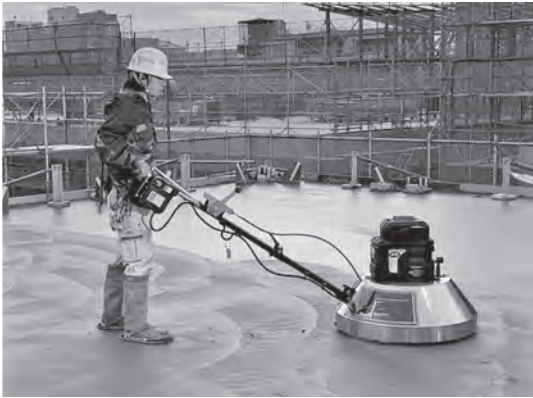
写真—9 作業所での活用状況
