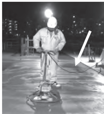
写真—2 配線が必要な電動機械
