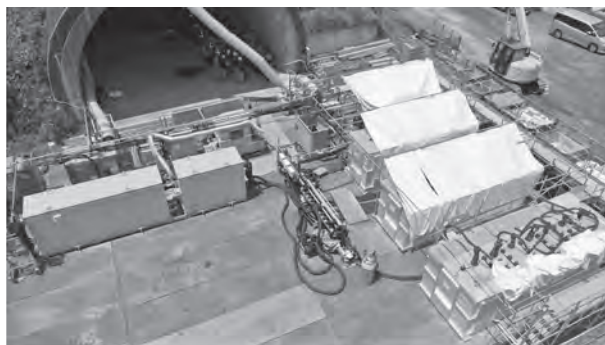
写真—3 実験全景（凍結プラント（左）実験土槽（右））
