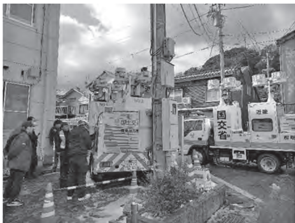
写真—13 照明車による電源支援（関東・近畿・中国）
