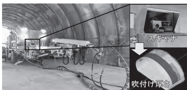
図—2 吹付機搭載型の計測システム
