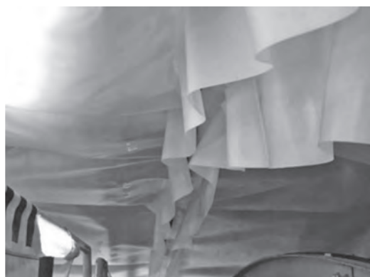
写真—3 防水シート余溶着部のたわみとよれ
