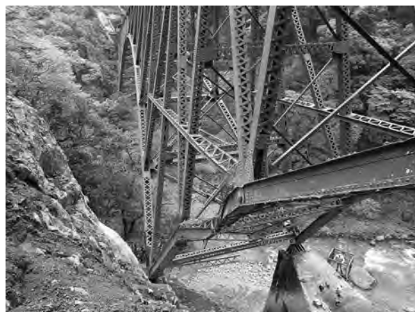
写真三 土砂による下弦材変形
