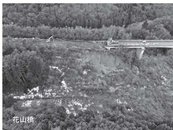
写真—5 沢埋め高盛土の被災（能登大橋南側）
