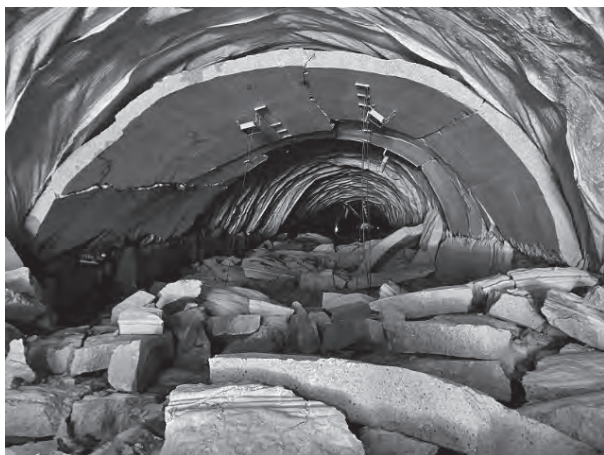
写真—4 覆工コンクリートの崩落（大谷トンネル）
