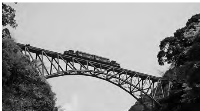
写真一 震災前の第一白川橋梁
