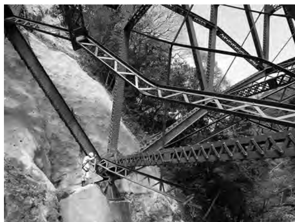
写真二 対傾材・下横構の破断
