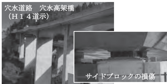
写真—6 新しい基準の橋の損傷例
