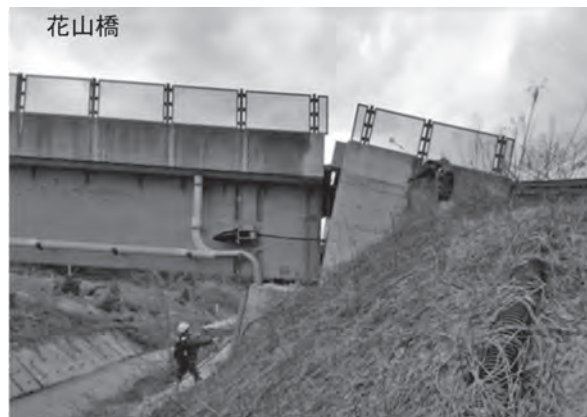
写真—7 地盤からの変位の影響による橋台の被災例
