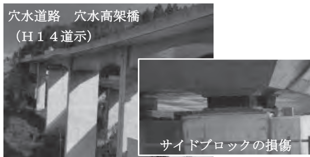
図一 4 新しい基準の橋の損傷例
