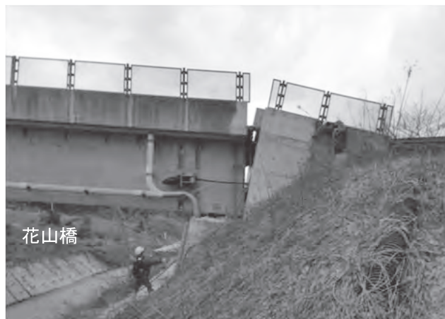
図一 5 地盤からの変位の影響による橋台の被災例
