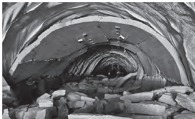
図二 覆工コンクリート崩落（大谷トンネル）
