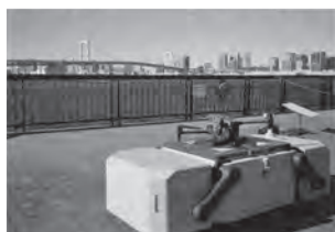
c) DJI Dockの設置状況
