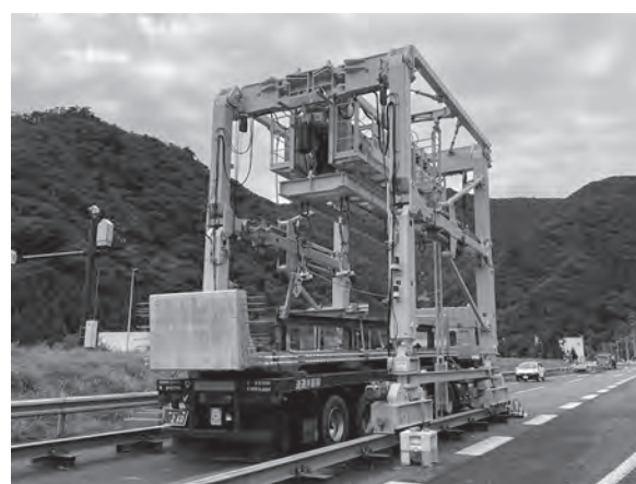
写真—5 移載リフター
