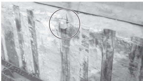
図—9 傾斜センサユニットによる山留変位の自動計測
