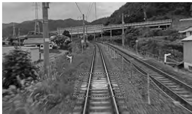
写真一4 噴泥・バラスト不足の例
