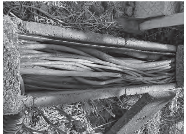
写真一 二 線路脇に敷設されている信号ケーブル
