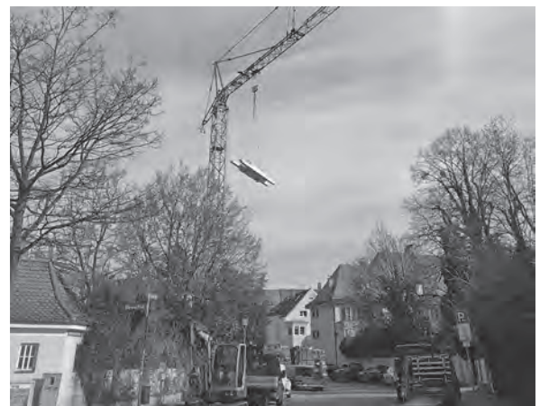
写真一41 ミュンヘン郊外の住宅のリニューアル工事(電動のジブクレーン)
