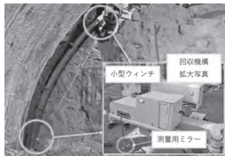
写真一3 ミラー回収機構
