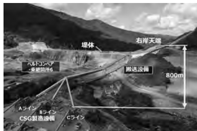
写真一2 搬送設備（プラント～右岸天端）
