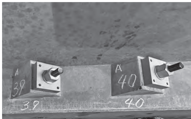
写真ー5 縦目地 PC 鋼材の定着体
