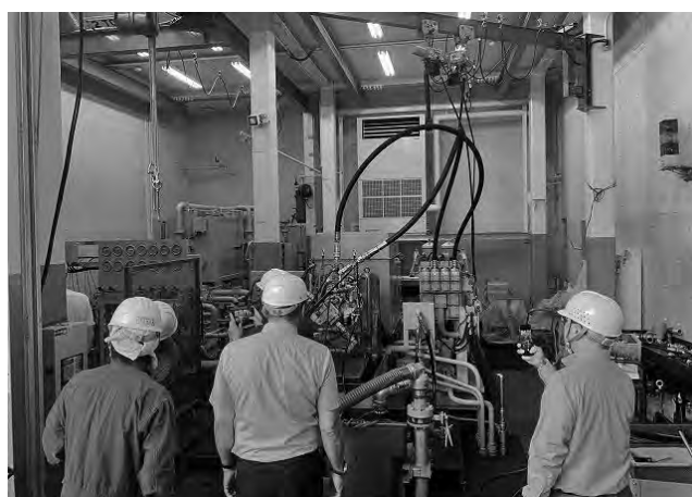
写真-6 油圧ポンプ工場
