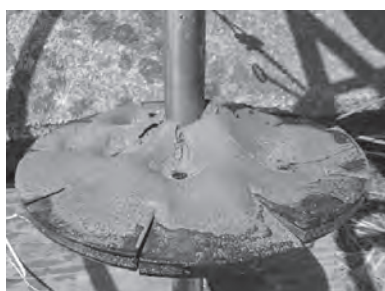
写真—3 管外側の固着物
