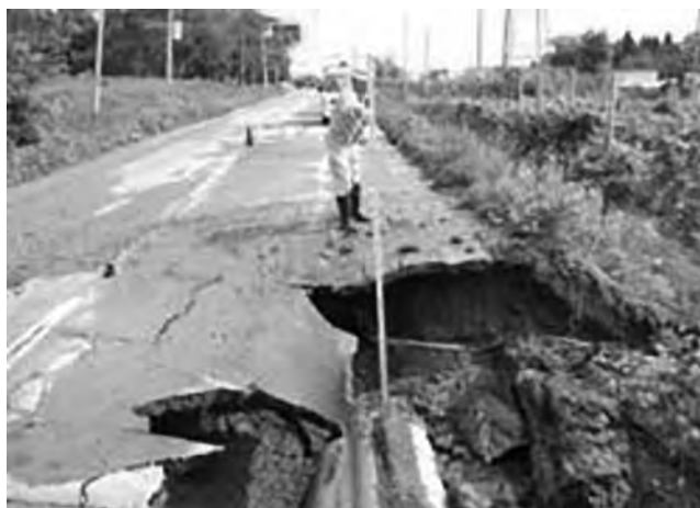
写真一 パイプラインの突発事故の例
