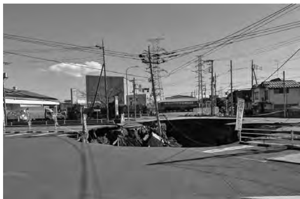
写真—1 1月30日 陥没拡大後の写真
