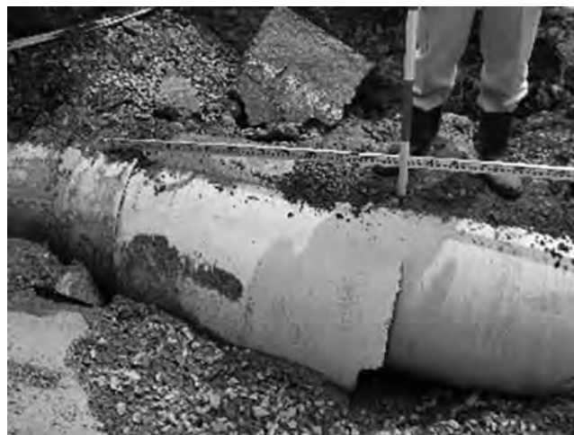
写真二 破損状況
