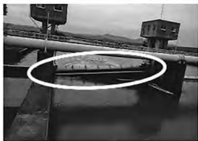
巻上げ機の故障によるゲート片吊り
