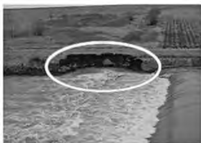
護岸工の損壊
