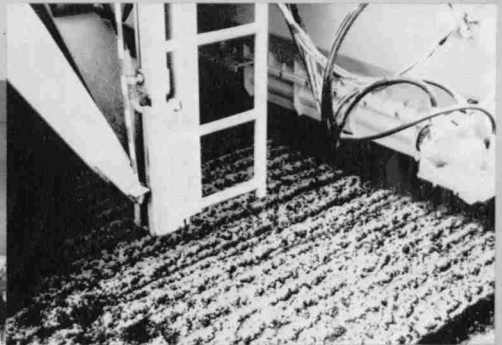
⇨ 大成道路・ヒートリフォーマ (かき起し後吸油材散布状況)
