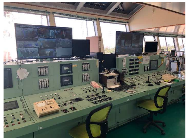
写真-2 Webカメラによる設備監視画面モニター
