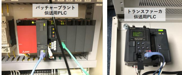
写真-9 バッチャープラント通信機器
