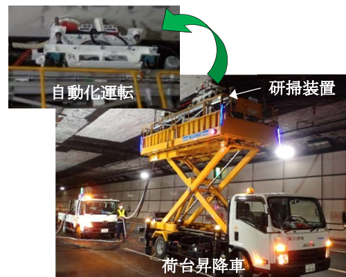
写真-2 自動化運転によるトンネル天井面の研掃作業 (研削ビットを用いた乾式の天井用研掃装置)
