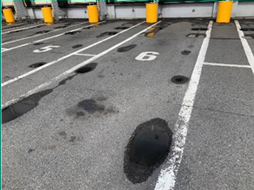
施工前状況 沈下および流動
