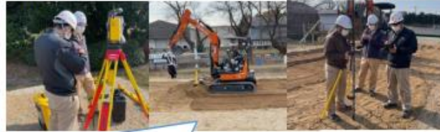
重機への機器設置作業は平均1時間程度（工場で取付け治具の事前溶接・キャリブレーションをしておけば現地作業を10分程度に短縮可能）
