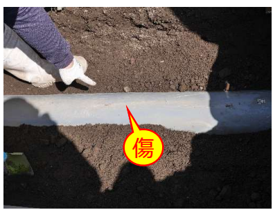
バケット接触による 損傷 VU150A
