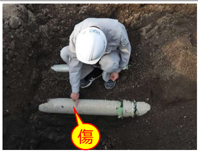
バケット接触による 損傷 SGP150A
