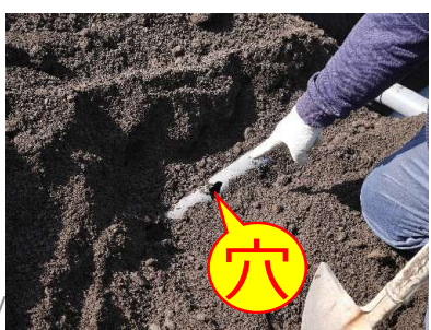
バケット接触による 破損 VU50A
