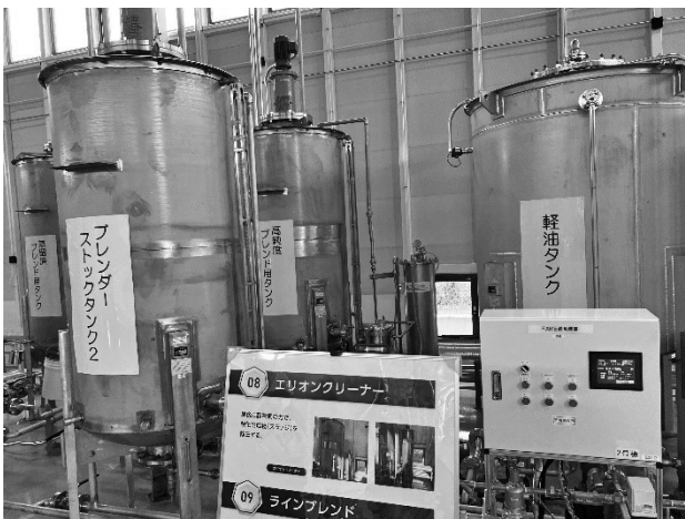
写真—5 軽油、重油との混合用設備
