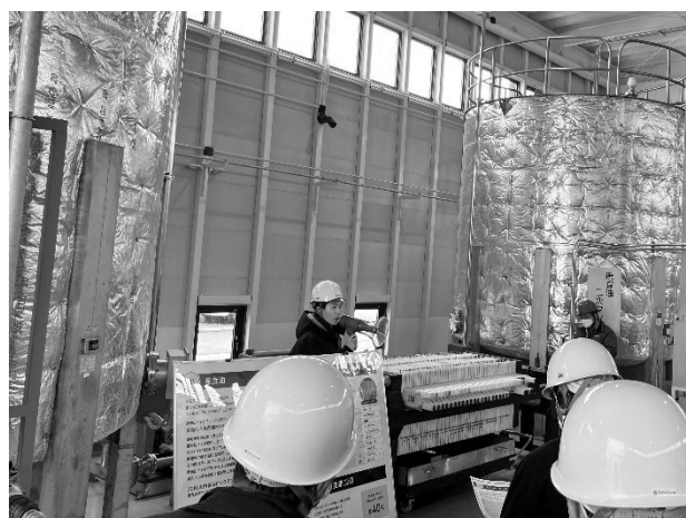
写真-3 一次、二次タンクとプレスフィルター
