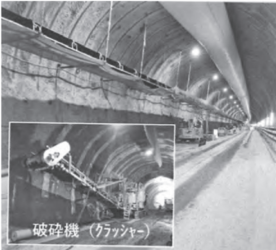
写真一2 連続ベルトコンベアと破碎機（天神トンネル作業所現場概要資料より）
