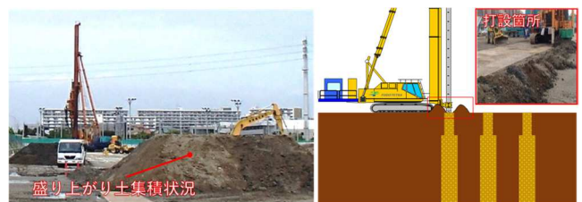
写真-1 盛り上がり土の発生状況例
