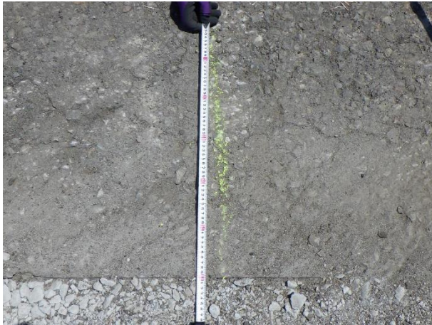
写真-6 舗装上のクラック
