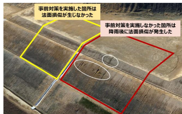
図-8 モデルエリア降雨後の法面損傷状況（4月22日地形）
