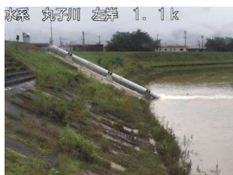
写真-1 排水運転状況 (R6.7 大仙市実証設備)
