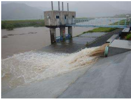
写真-2 排水運転状況 (R5.6 四万十市実証設備)
