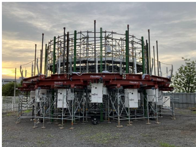
写真-5 実験設備外観
