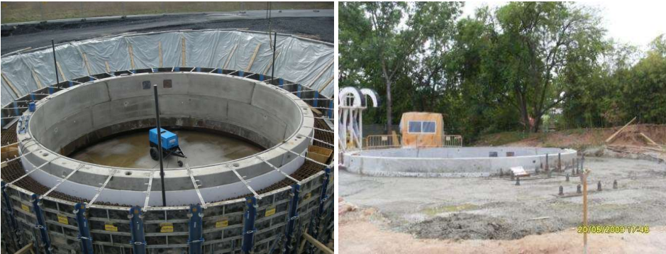
Lost ring beam リング基礎
