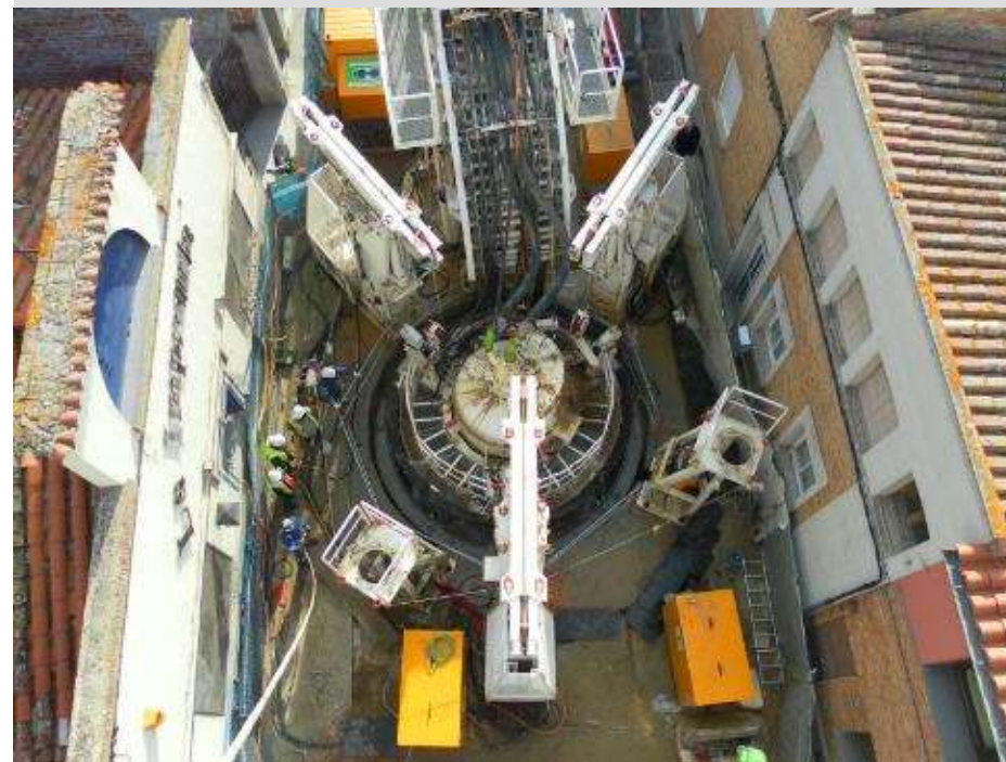
Girona, Spain ジローナ・スペイン Shaft OD up to \Phi 5,950 mm 立坑外径 \Phi 5,950 mm
