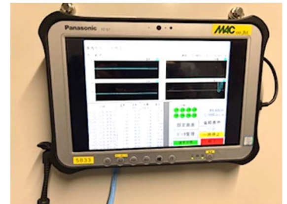
(6) 室内環境モニタリングシステム
