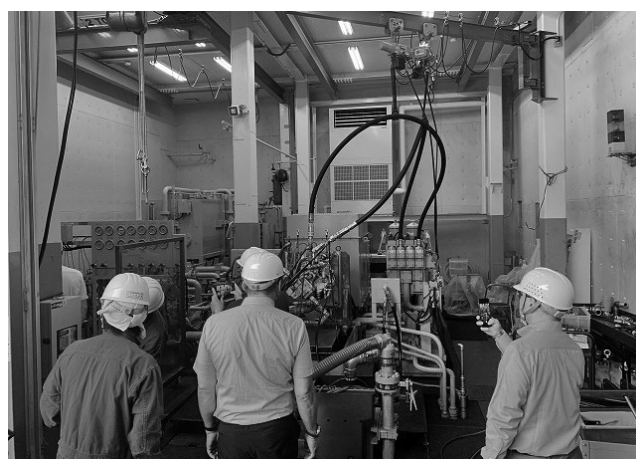
写真-6 油圧ポンプ工場
