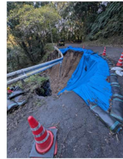
写真4 山間部の斜面崩壊
