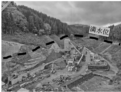
写真—5 貯水域側（プラント設備）
