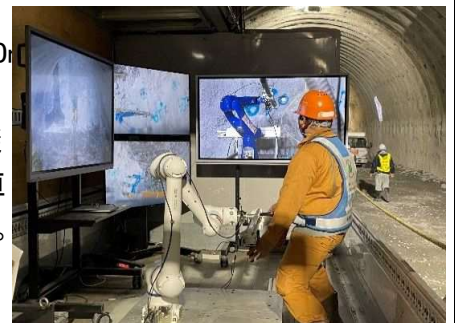
図-2 オペレータ室
