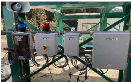
電話・一斉放送設備設置例
