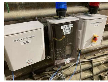
坑内電話・一斉放送設備設置例
