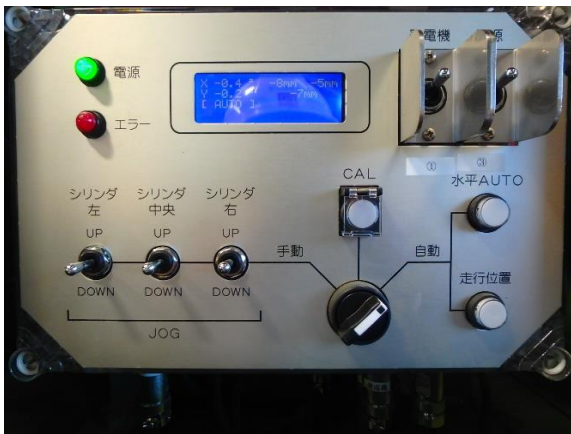
写真-5 自動水平維持装置制御ユニット
