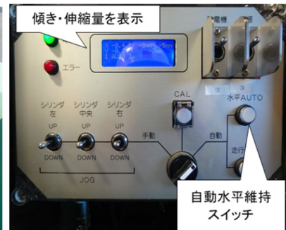
制御ユニット
