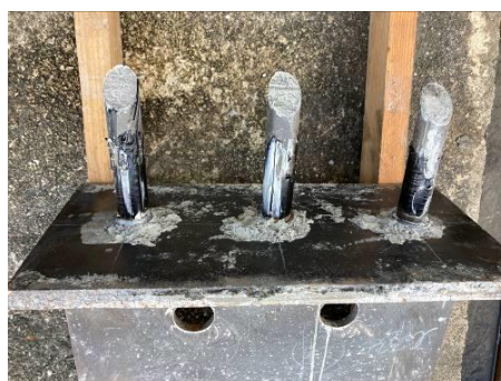
写真-4 頭部を切断したスタッドジベル
