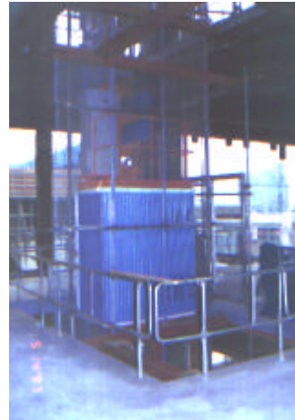
写真 2.4.4 一本構工事中用エレベータ
