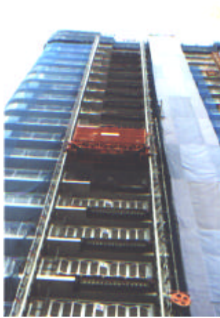
写真 2.4.3 二本構工事中用エレベータ
